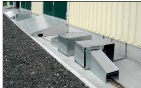
Antriebswinde EW4 und Querkanalabdeckung
