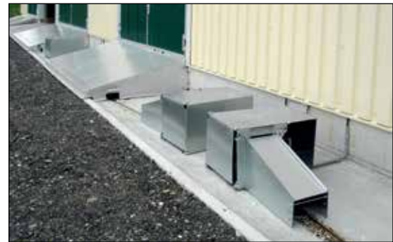
Antriebswinde EW4 und Querkanalabdeckung
