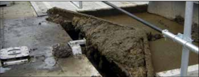
Faltschieber am Abwurf
