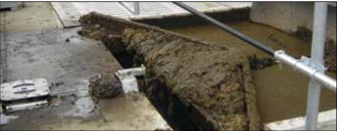
Faltschieber am Abwurf
